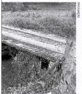
Ponte está em situação precária em Itapoá
